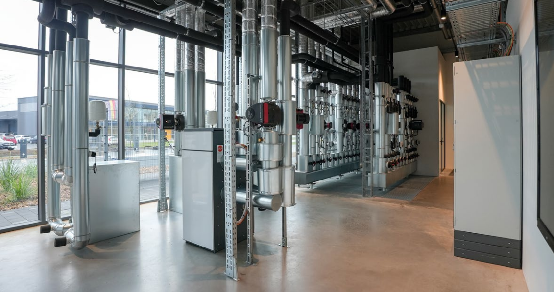
Bild (nachher): Die final installierte Heizungsanlage
